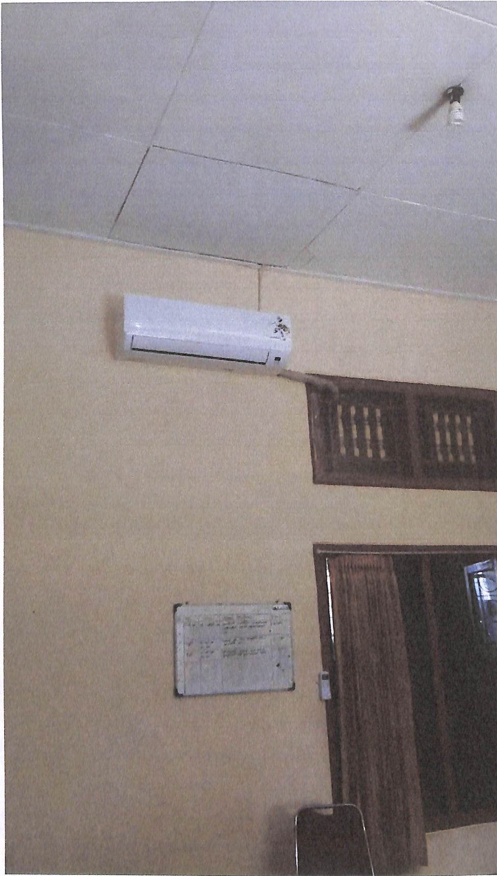
Pengadaan AC Split Tahun 2016 Merk Honshu 2 PK di Sub Bag Perencanaan Dinas Pertanian dan Peternakan Kab. Buleleng
