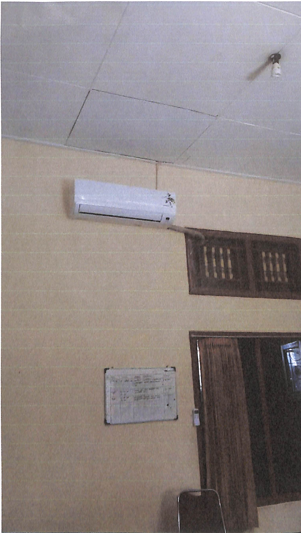
Pengadaan AC Split Tahun 2016 Merk Honshu 2 PK di Sub Bag Perencanaan Dinas Pertanian dan Peternakan Kab. Buleleng
